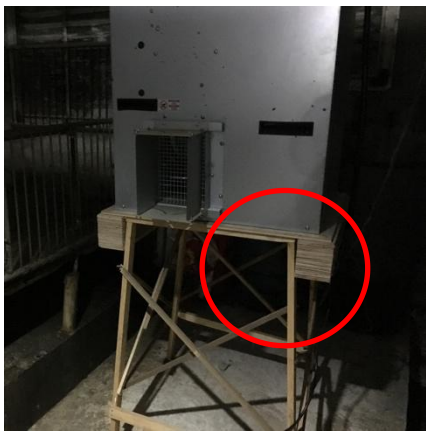
底部进气窗被堵死，导致不完全燃烧积碳和有害气体超标
