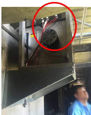
安装空间局促 后期无法检修
