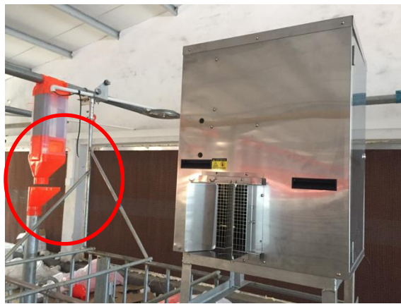
热风出口近200°C高温，致使塑料料槽变形融化
