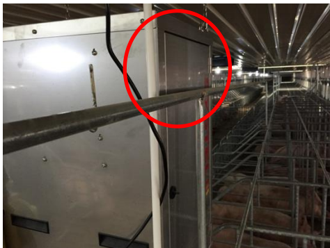
安装空间局促 后期无法检修
