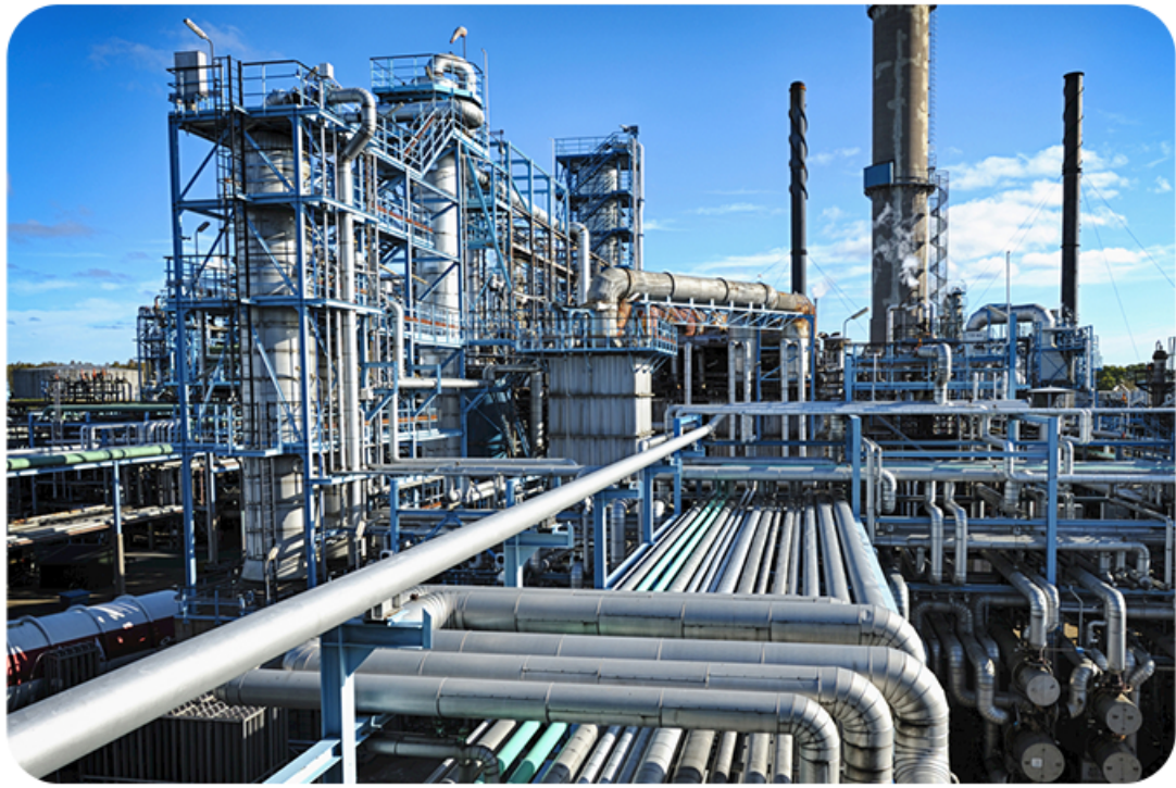
能源管道监控
