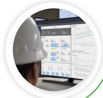
能源站中控室
