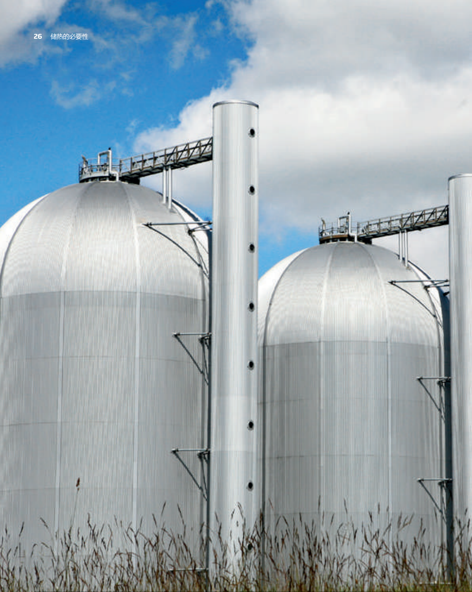
图为哥本哈根附近的 Avedøre 热电联产厂的两个大型日常储热罐。使用这些储热设施可帮助热电厂在电价合适时发电，而在电价格较低时储存余热供以后使用。因此，储热系统有助于改善热电厂的经济状况。
