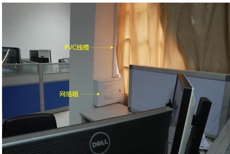
图 3-24 阅片室采用信息配线箱改造
