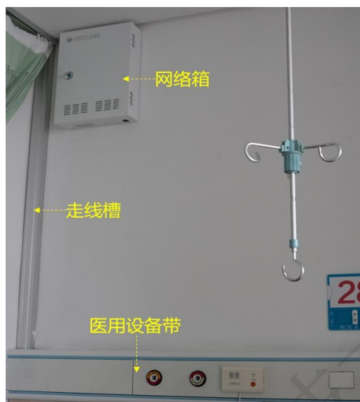
图 3-15 病房内网线走线
