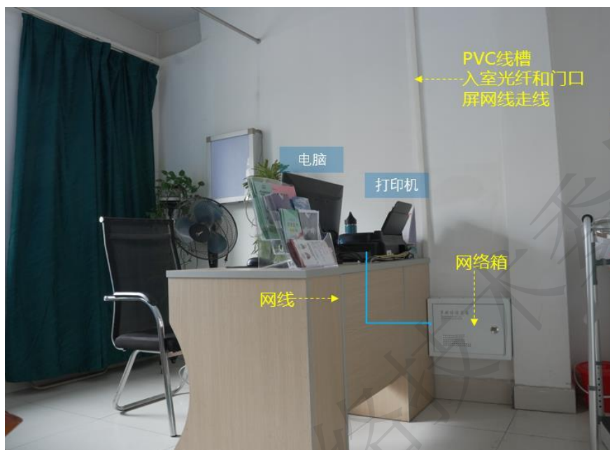
图 3-8 诊室内信息配线箱的安装位置
