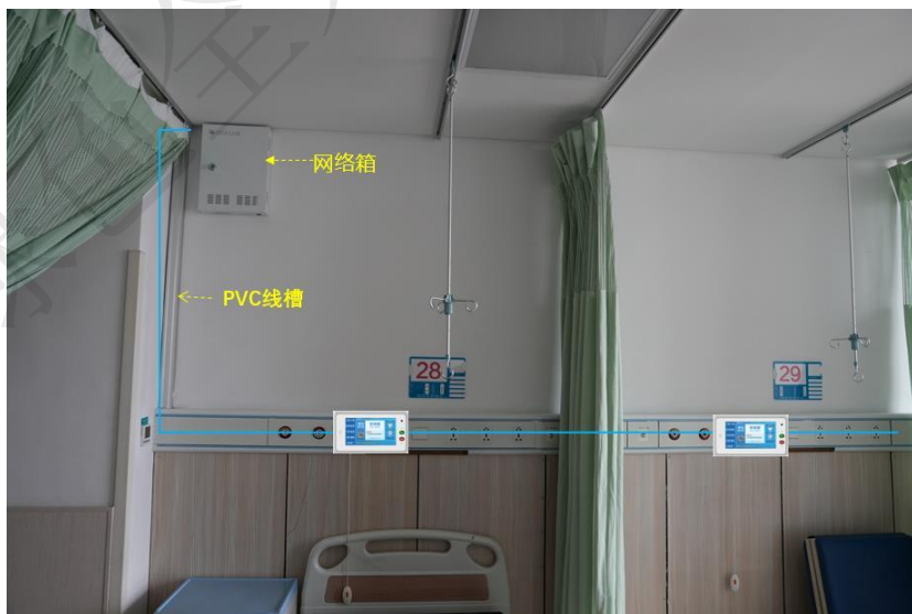
图 3-13 病房内信息配线箱的安装位置
