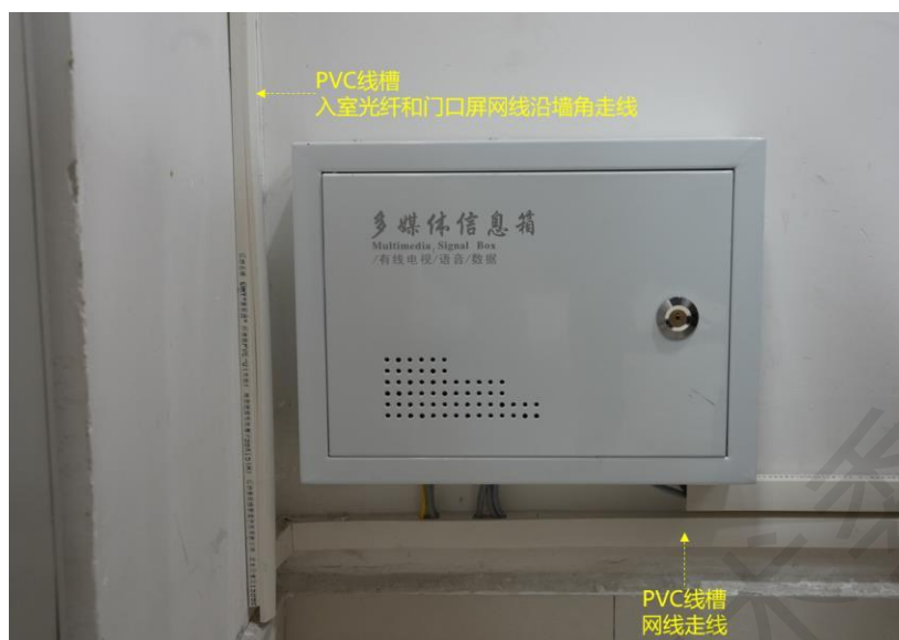
图 3-9 通过线槽将光纤/网线引入至信息配线箱
