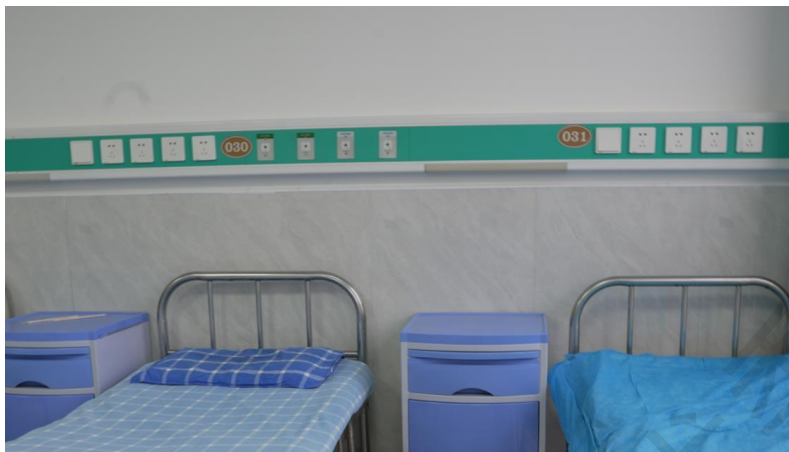
图 1-8 病房无预留接床头屏的网口
