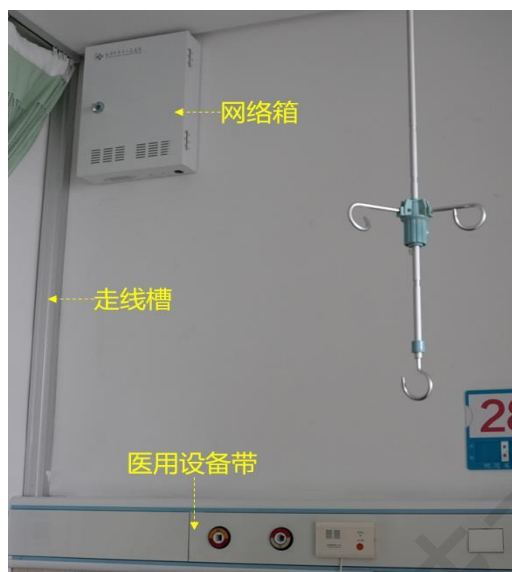
图 3-15 病房内网线走线
