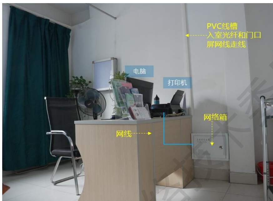
图 3-8 诊室内信息配线箱的安装位置
