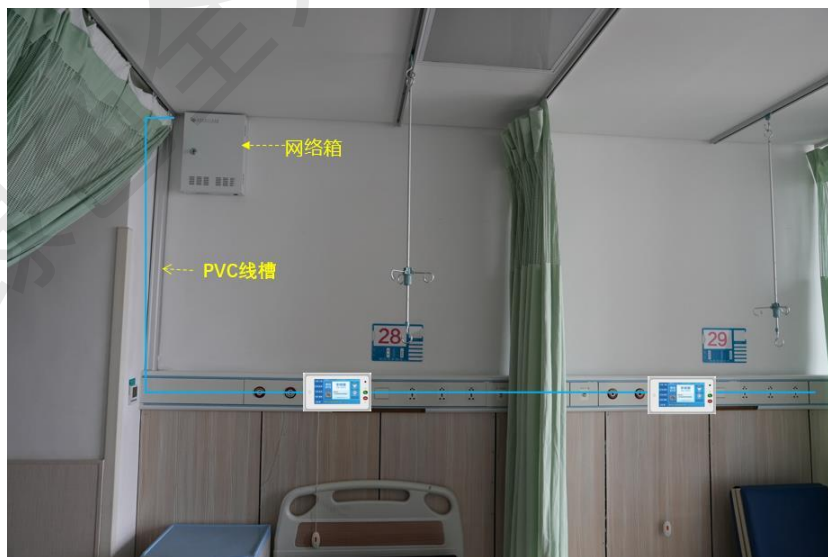
图 3-13 病房内信息配线箱的安装位置
